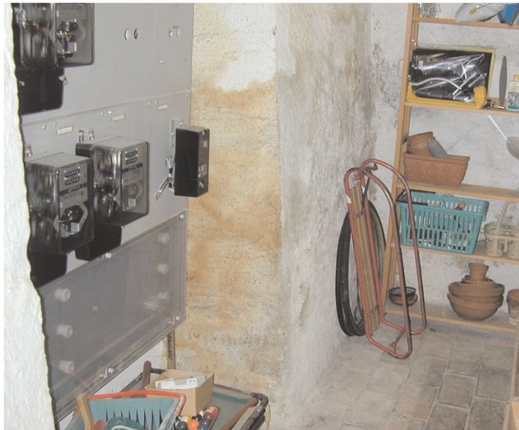
Mauerfeuchtigkeit kann verschiedene Ursachen haben.
